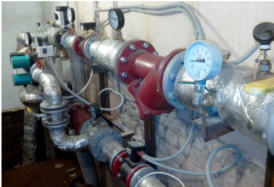
Рисунок 1. Общий вид автоматизированного теплового пункта
