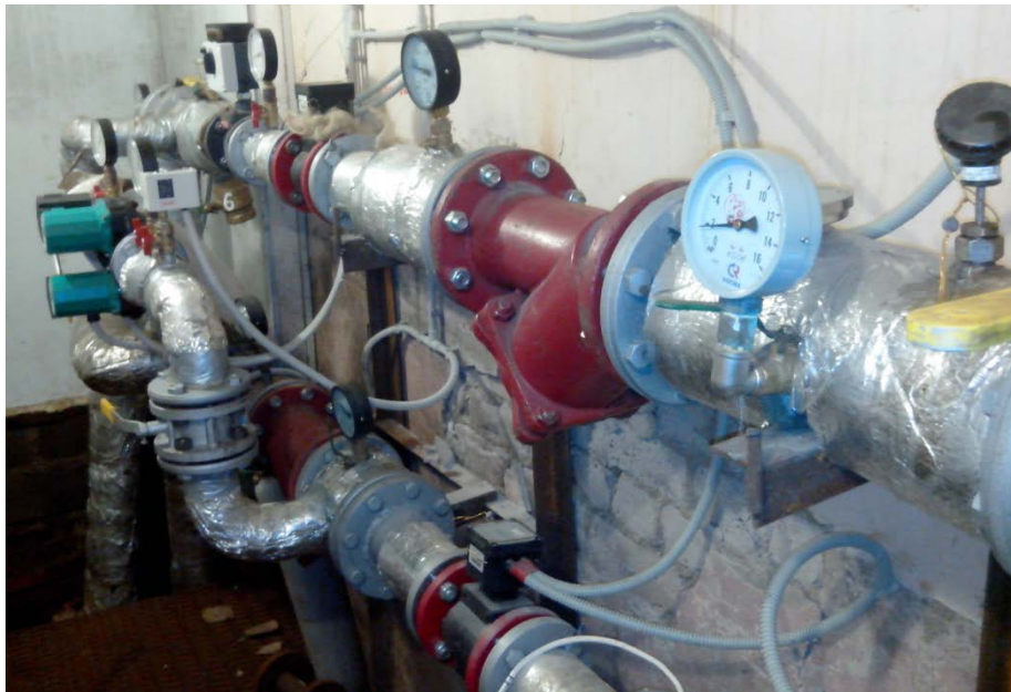
Рисунок 1. Общий вид автоматизированного теплового пункта
